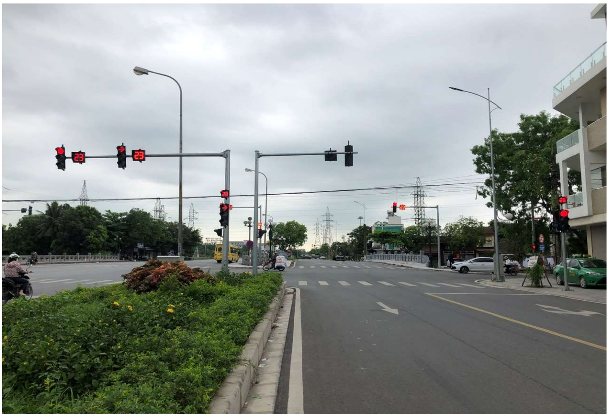
Cụm đèn tín hiệu giao thông tại Nút giao Quốc Lộ 10 giao với đường Trần Thái Tông, TP. Nam Định, tỉnh Nam Định
