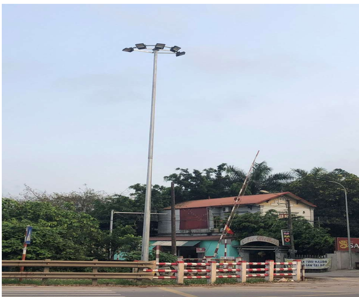
Cột chiếu sáng cao 14M và Cụm đèn tín hiệu giao thông tại Nút giao giữa QL.1 và đường Lý Nhân, thành phố Tam Điệp, tỉnh Ninh Bình
