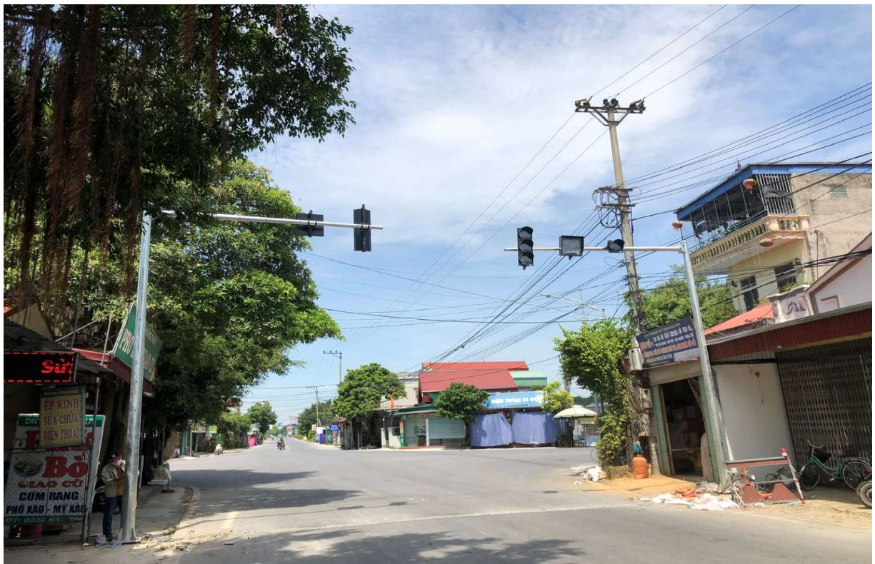
Cụm đèn tín hiệu giao thông tại Nút giao Ngã tư Đồng Đội, xã Công Hòa, huyện Vụ Bản, tỉnh Nam Định
