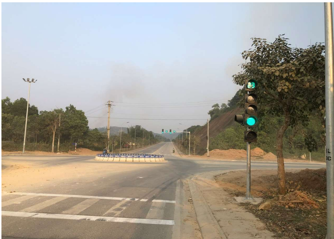
Cột chiếu sáng cao 14M và Cụm đèn tín hiệu giao thông tại Nút giao giữa đường dẫn cầu Tuần Quán và đường nối Quốc lộ 37 với đường cao tốc Nội Bài - Lào Cai thuộc phường Yên Ninh, thành phố Yên Bái
